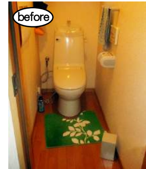
▲ 手洗い付のタンク式トイレでした。
